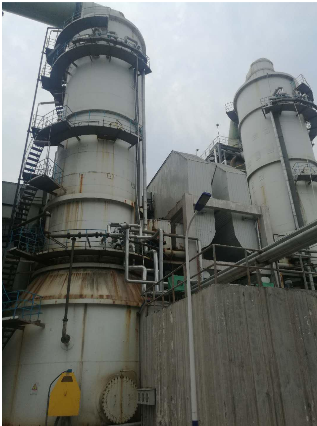
图 2-12 项目脱硫装置
