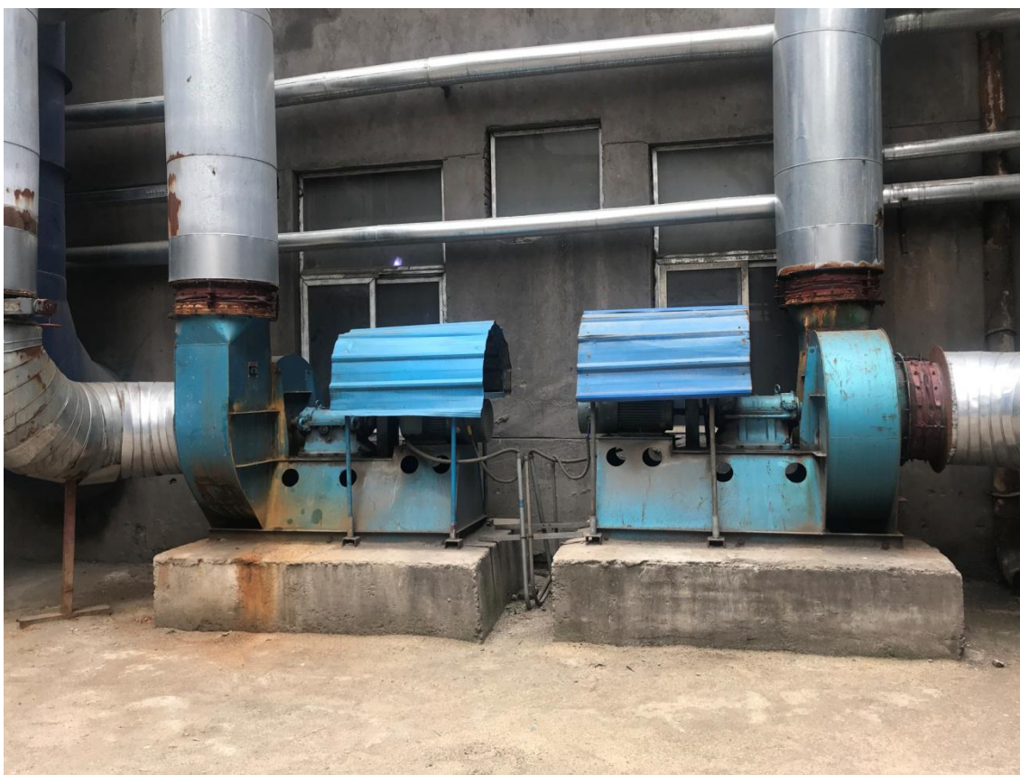
图 2-11 项目脱硝装置 (SNCR 循环风机)
