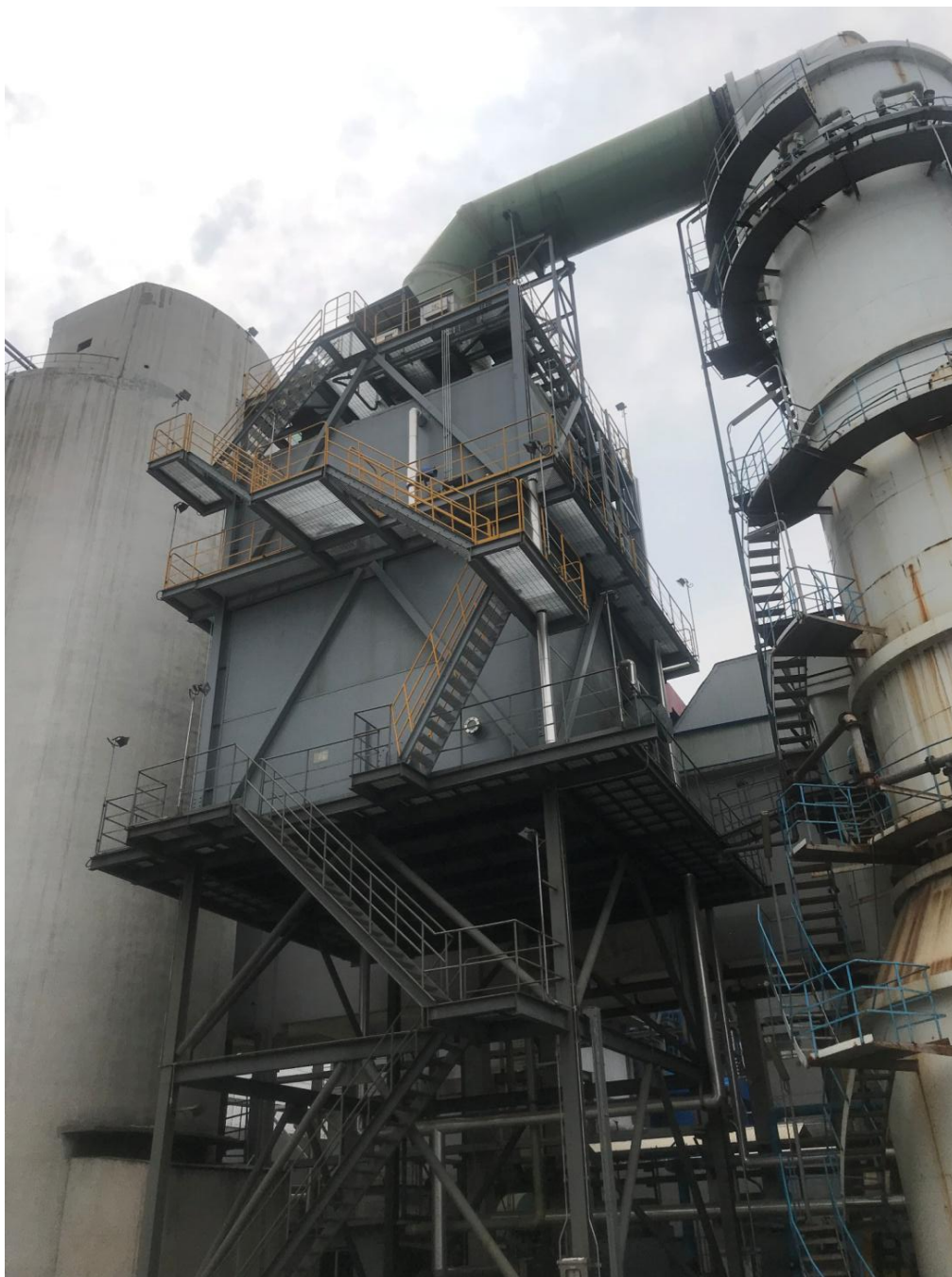
图 2-13 项目湿电除尘装置
