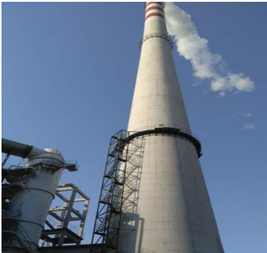
图 2-3 项目锅炉废气处理后烟囱
